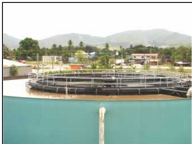
Figure 4. Station d'épuration de Malabar à Trinité.
